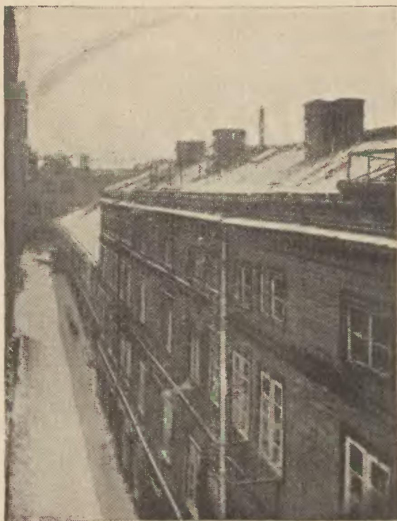
Mattenbuden 29, schmales, langes, hohes Hofgebäude mit 20 Kleinst- wohnungen. Dicht vor den Fenstern raubt die hohe Brandmauer einer erst kürzlich gebauten Mietkaserne den Arbeiterwohnungen jede Sonne.
